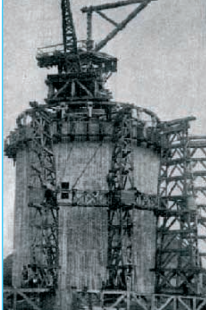
Angers, la construction d'un des châteaux d'eau de la rue Raphaël Berry 1934 - Photo Ville d'Angers
